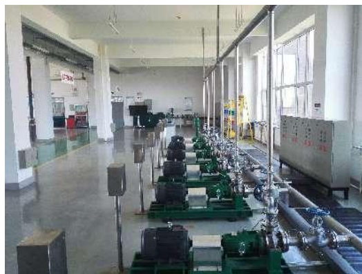
图 20 化机维修实训中心设备
